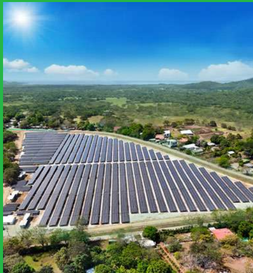
Parque Solar Huacas
